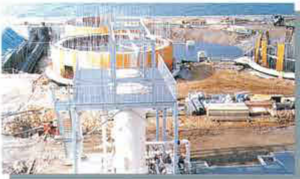
下水処理場消化槽
