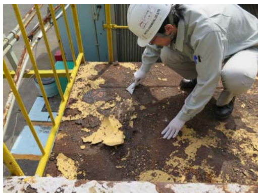
① 施工前（旧塗膜の浮いた状態）
